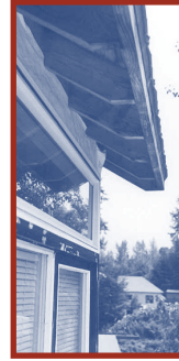
Saillies de toit ouvertes, orifices de ventilation non grillagés (6 points)
